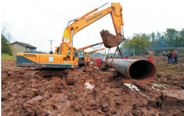
Участок газопровода в городе Чунцин между городскими округами Чжунвай и Гуйян
